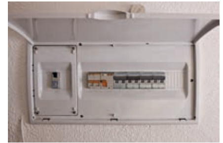
Cuadro general de mando y protección del interior de una vivienda.
